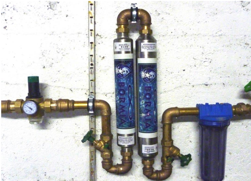
Mustergültiger Einbau einer Bormia-Hausanlage!
